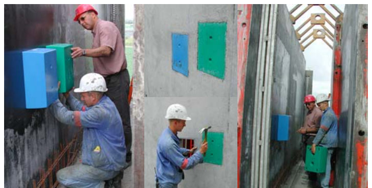
Opérations de coffrage et de décoffrage sur le chantier EURASANTE à LOMME
